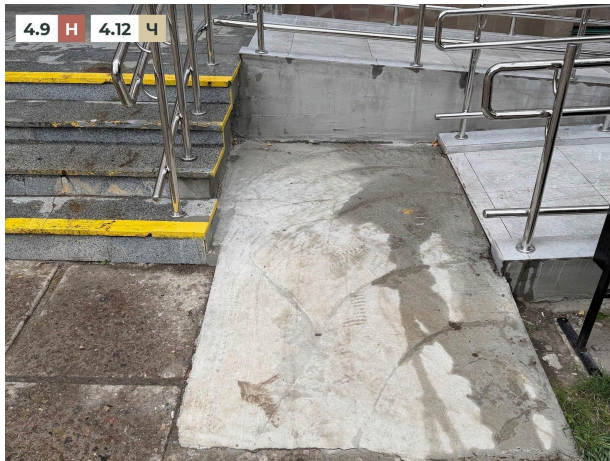
Фото 3. Нижня похила ділянка без поручнів, покриття з цементної стяжки (поз. 4.9, 4.12)
