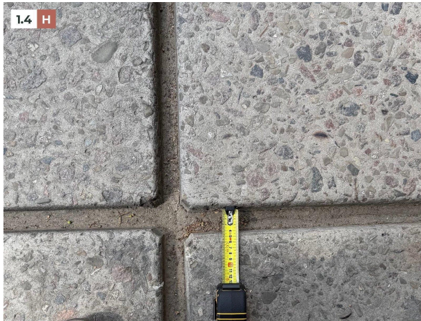
Фото 1. Розкриття швів плитки перед будівлею до 40 мм за допустимих 15 мм (поз. 1.4)
